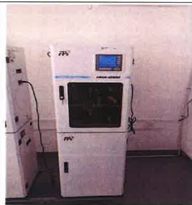
1. 设施排口总铅监测设备
